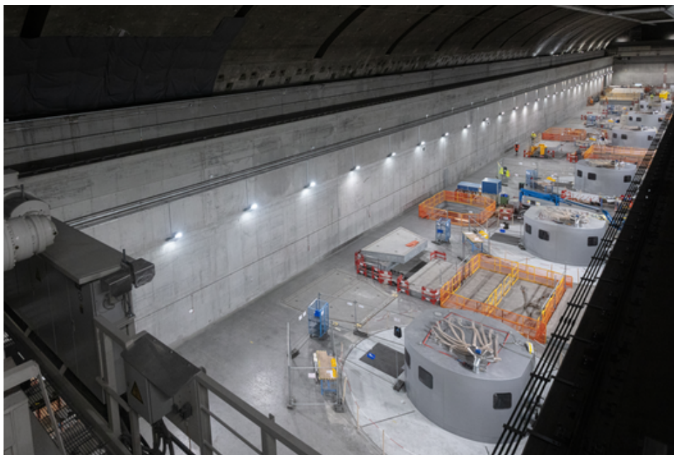
La «caverne des machines», creusée dans les entrailles de la montagne, mesure près de 200 mètres de long. Six pompes-turbines de type Francis sont alignées, elles sont chacune dotées d'une puissance de 150 MW. — Thierry Serrier pour Le Temps
